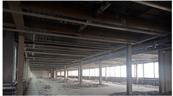
La structure métallique, visible une fois les éléments du bâtiment enlevés. Après le sablage du flocage résistant au feu, elle sera déconstruite et envoyée vers une fonderie pour un recyclage de haute valeur. © Buildwise
