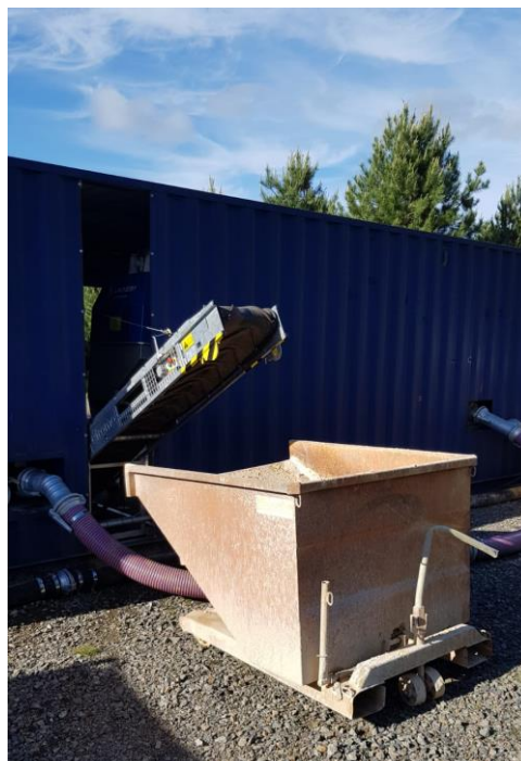
Photo 1 : le nouvel équipement de déshydratation des boues
