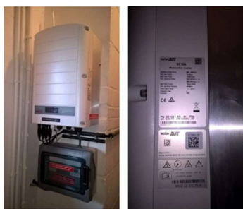
Onduleur: puissance 10 KVA Source : I. NIJSKENS
