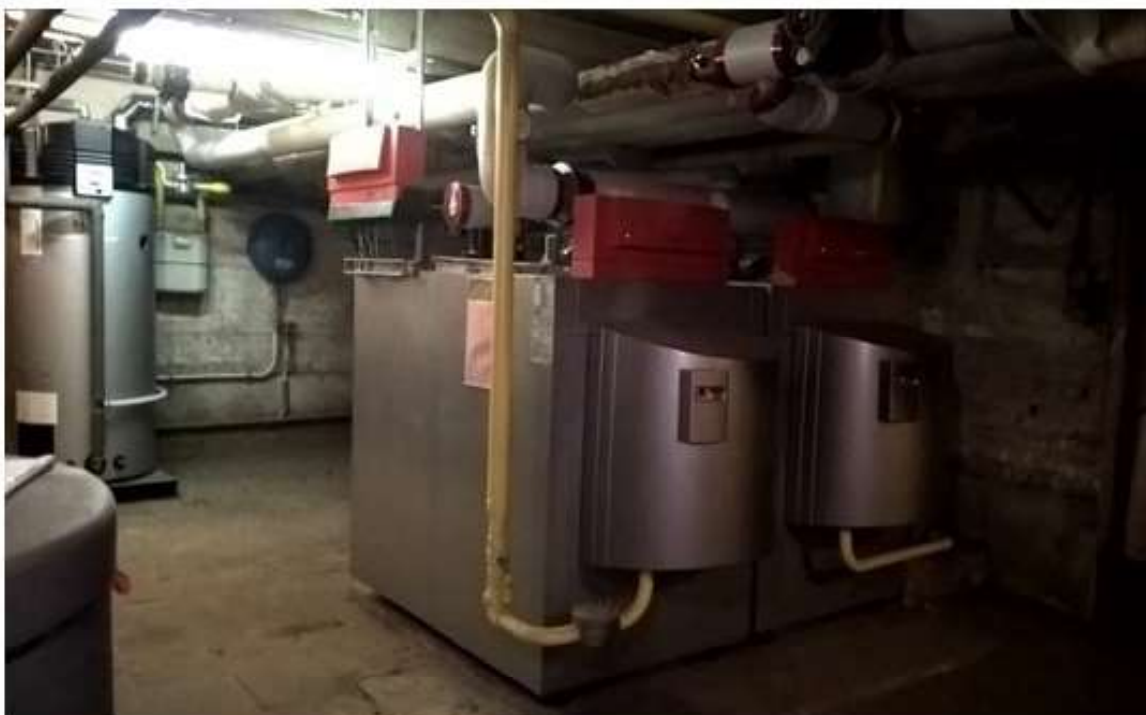
Systeme (chauffage et eau chaude sanitaire) Source : A. & M. Escarmelle sprl
